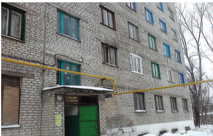
В доме большое количество ветхих оконных рам, дверь в подъезд почти всегда открыта...
