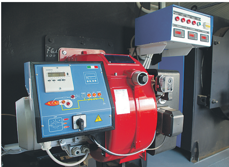
Теперь не человек управляет котельными - автоматика.
