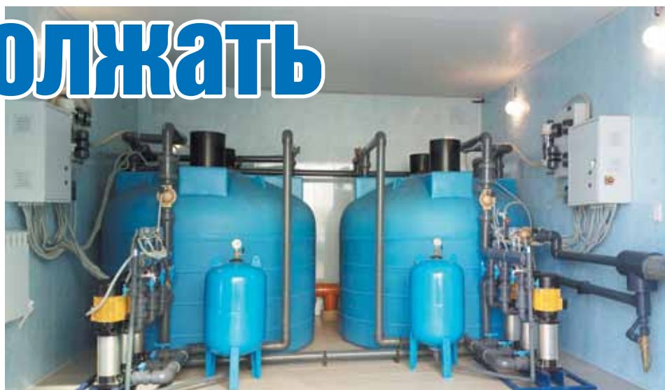
Станция доочистки воды в г. Котовске.
