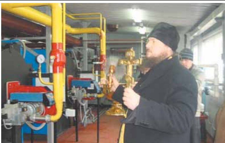
Открытие котельной в г. Уварово.
