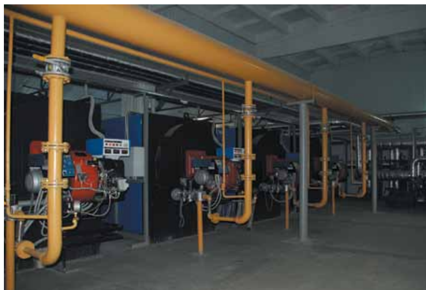
Котельная работает в автономном режиме.
