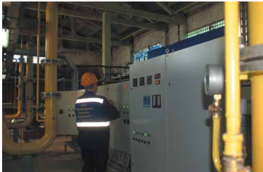
В обновленной котельной г.Уварово.
