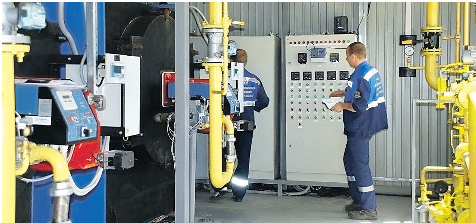
В новой котельной в г. Уварово.
