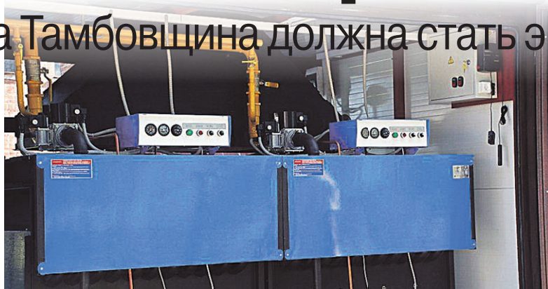
Котлы наружного размещения в котельной у школы №1 г. Котовска.
